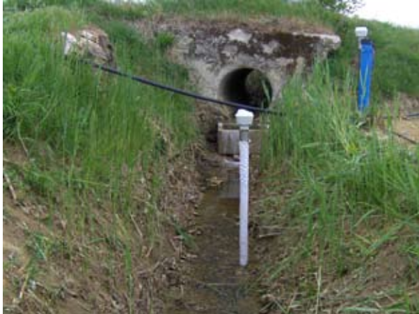
Figura 4: Misuratore di livello posto nel canale di drenaggio della fascia tampone
