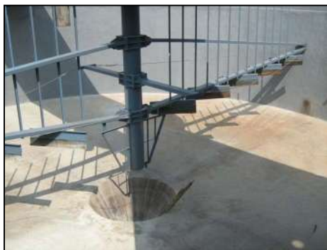
Figura 4: vasca accumulo fanghi
