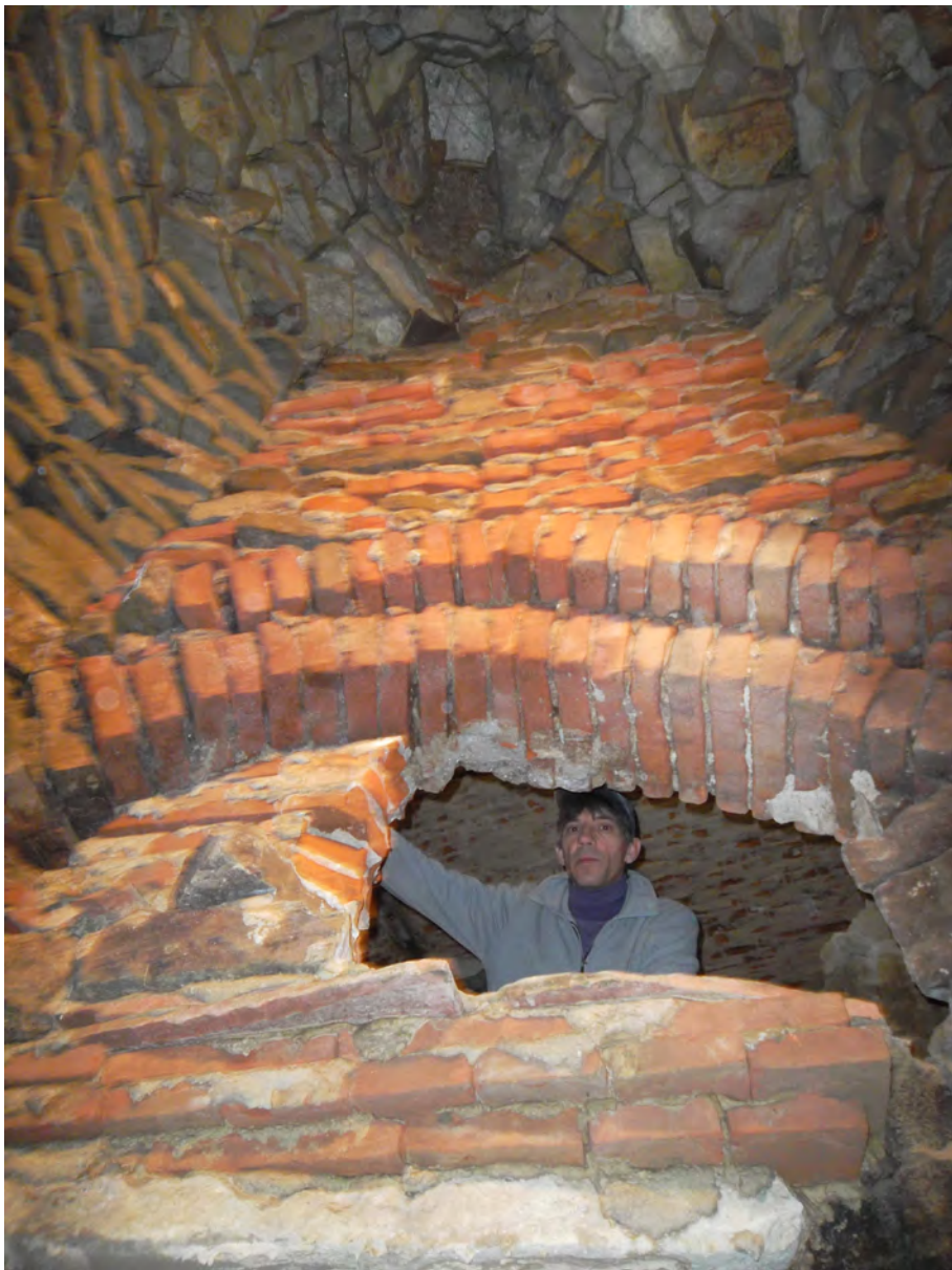
Figura 41: Tamponatura a mattoni sul fianco sud della struttura sotterranea a falsa volta, in corrispondenza della parete nord del vano INT 23, ovvero dello scantinato aperto in questa Fase 8 EST
