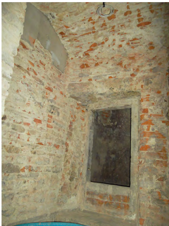
Figura 79: La modifica e lo sguancio di affaccio laterale al pozzo intonacato di INT 19, pozzo preesistente agli scantinati modificato non prima della creazione di INT 15 e della connessa scala di servizio
