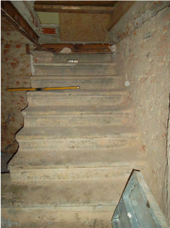
Figura 94: La scala che all'inizio dei lavori di ristrutturazione e delle indagini archeologiche da PT 26 scendeva in INT 13
