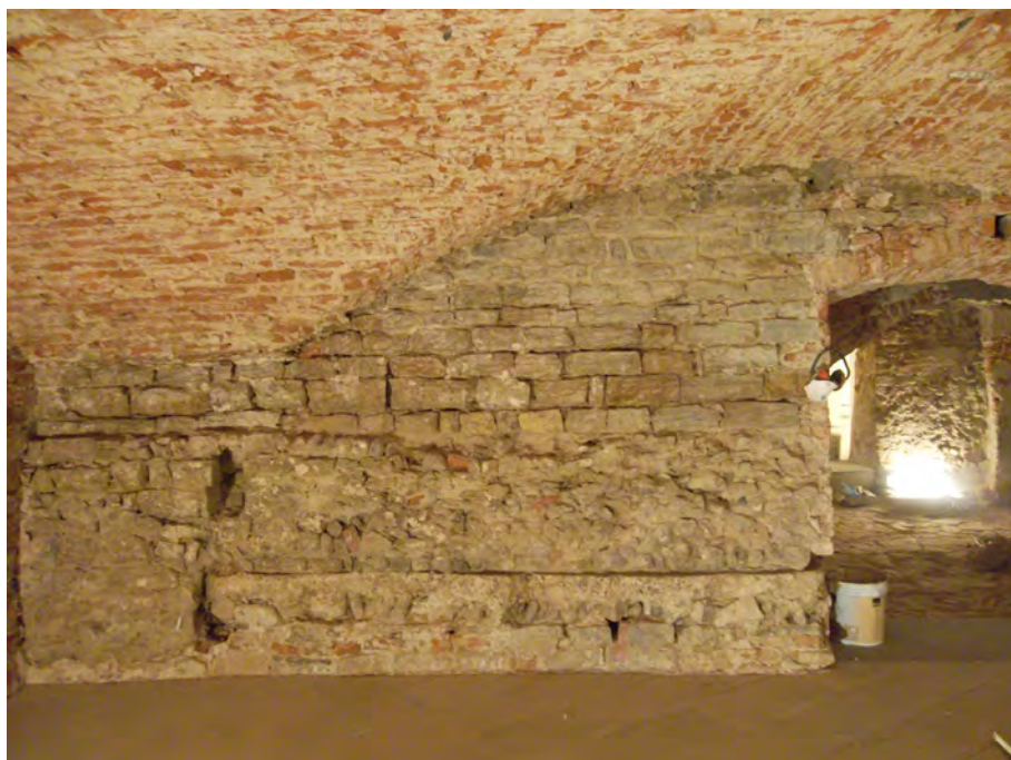
Figura 11: Tratto del pavimento in calcestruzzo del calcatorium o torcularium destinato alla produzione del vino (USM 76)
