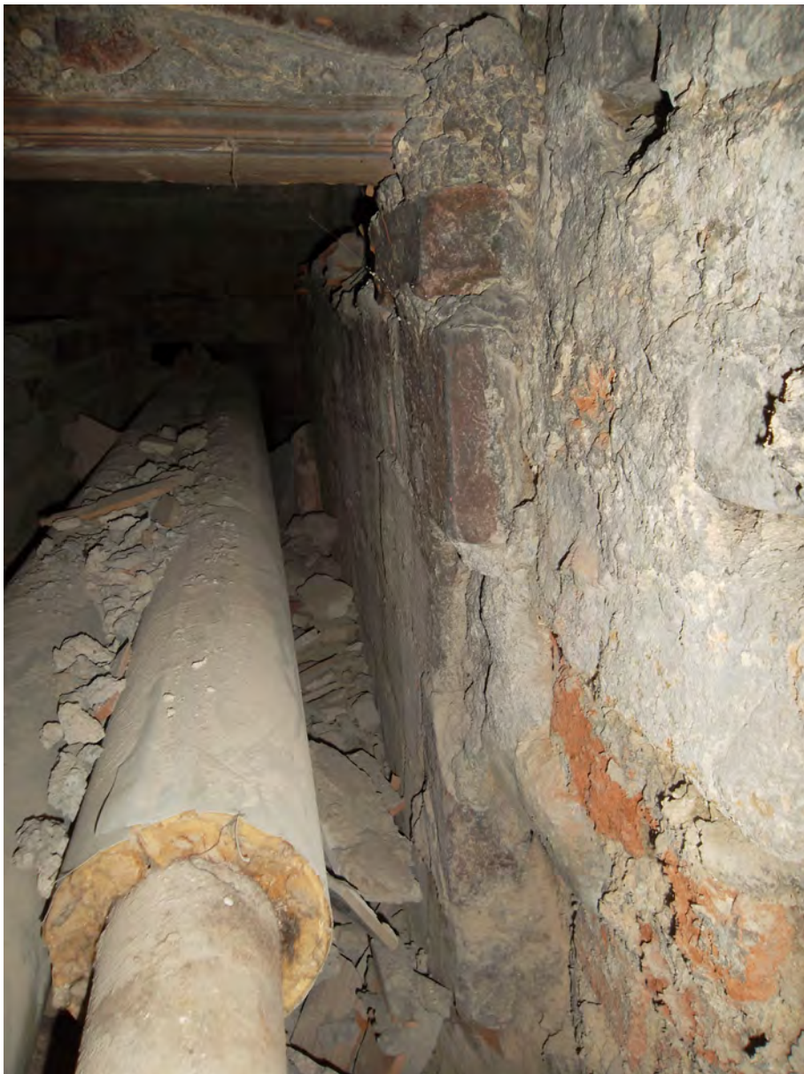
Figura 29: Testata settentrionale con tracce di sguancio della muraglia con andamento sud-nord sotto il muro tra PT 18 e PT 22, in pietre di consistente pezzatura, che delimitava a ovest il cortile settentrionale antistante la turris con funzioni di antiporta, e di cui lo sguancio indica la collocazione del portale esterno
