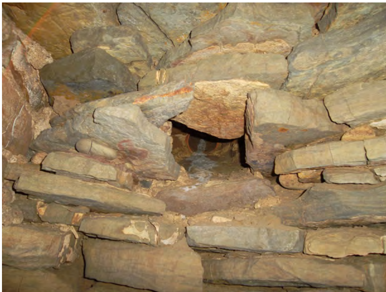
Figura 19: Tubo in cotto e connessa cassetta di adduzione sul versante occidentale della struttura a falsa cupola sotto PT 11, raccordo col sistema di raccolta e smaltimento delle acque piovane della turris
