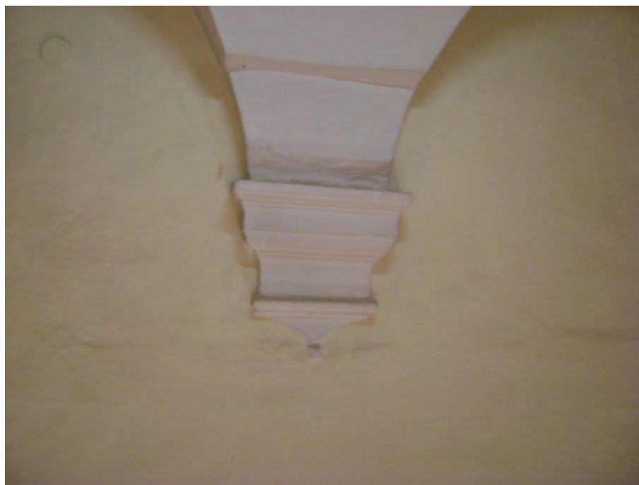
Foto 35 – Peduccio prima del restauro
