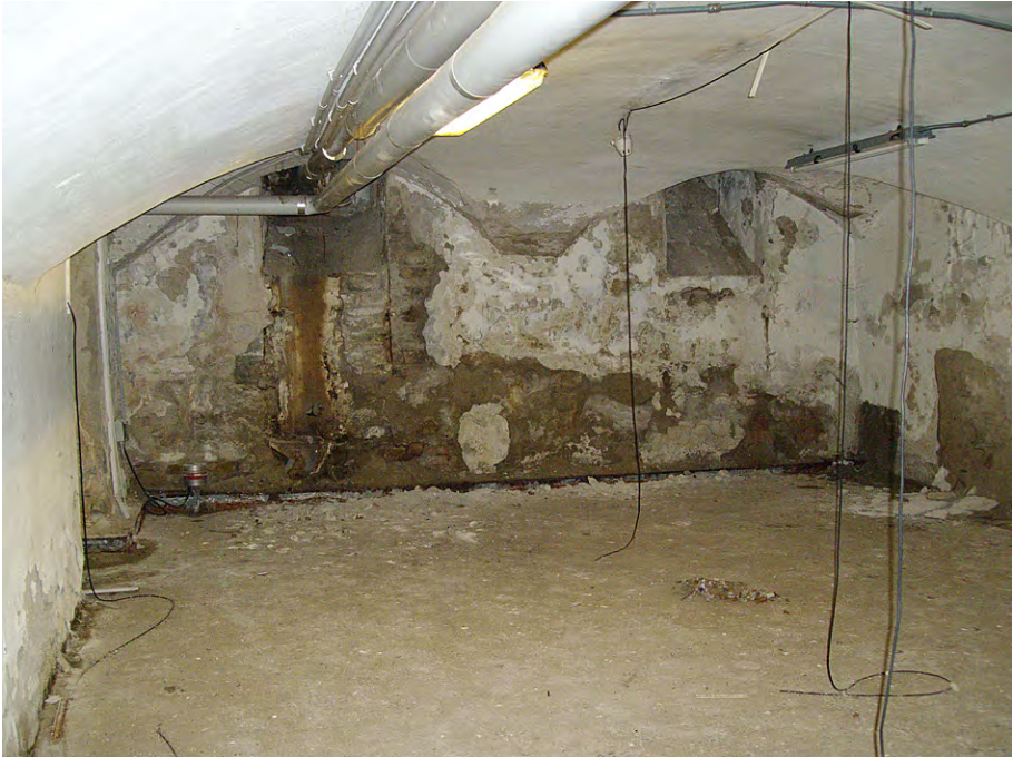
Foto 2 – Stato di forte degrado del piano interrato
