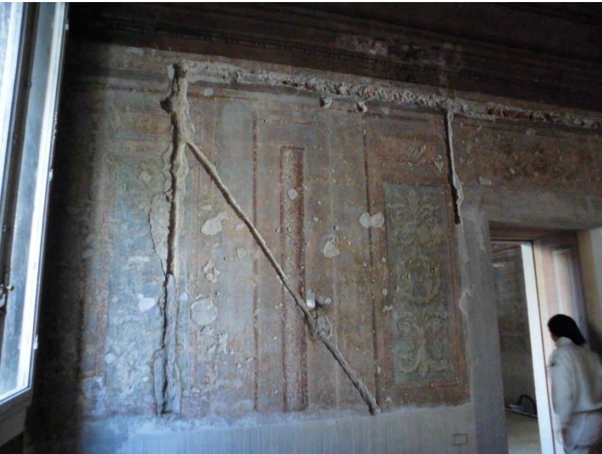
Foto 23 – Parete affrescata fortemente danneggiata da interventi per passaggio di impianti
