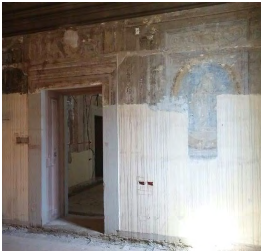
Foto 30 – Ritrovamenti pittorici dopo il descialbo
