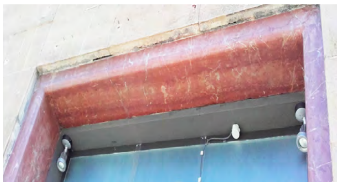
26. Particolare della cornice degli sipiti ed architravi delle aperture dei negozi in marmo rosso Amiata perlaceo
