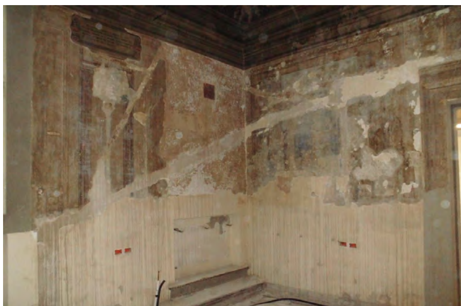
Foto 32 – Parete dopo il descialbo con danni dovuti a passaggio impiantistico
