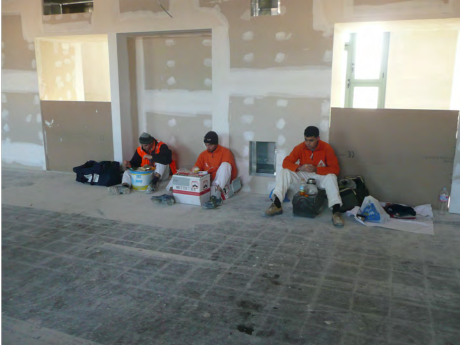
Fig. 4 – Cantiere in via Laura, Firenze 2005 (fotografia dell'Autore che ne autorizza la pubblicazione)
