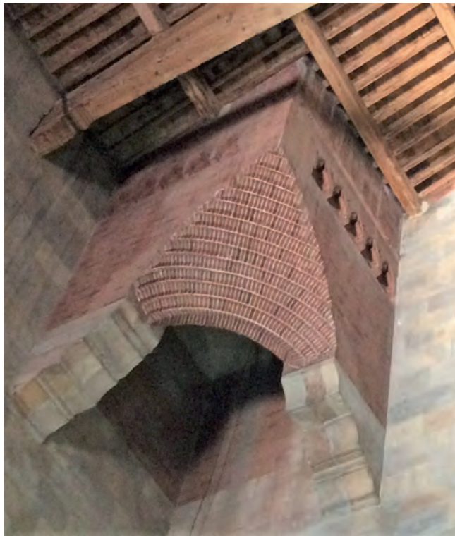
86 - Il campanile scarica il peso su due muri perimetrali in cui Giovanni di Simone inserì due mensoloni che sorreggono un'accuratissima tromba di mattoni concentrici alleggeriti da arcatelle (foto di Franco Mariani).
