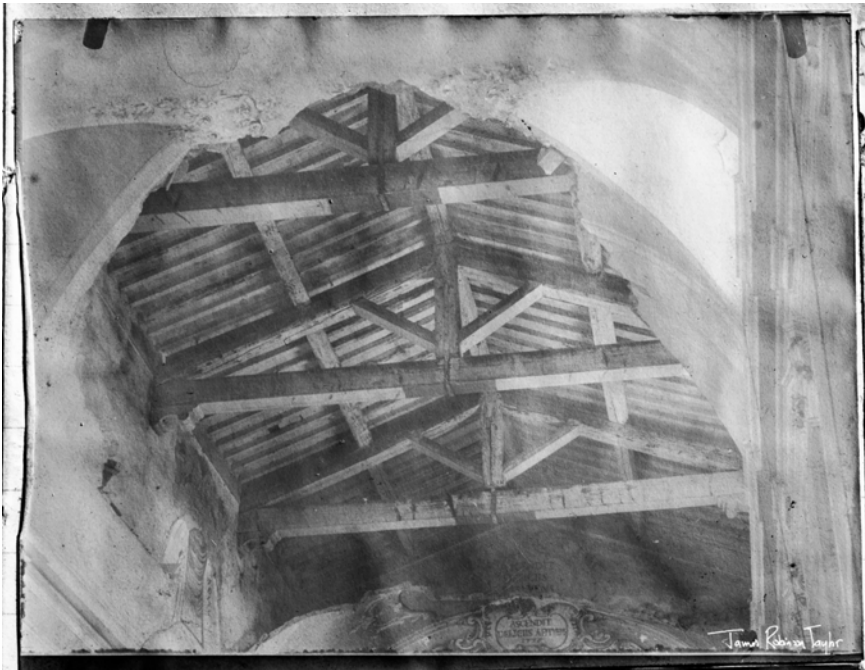
Fig.110, APF, Ricordi della chiesa di Fagna 1895-, fotografia della volta dopo il crollo del 29 giugno 1919 / James Robinson Taylor
