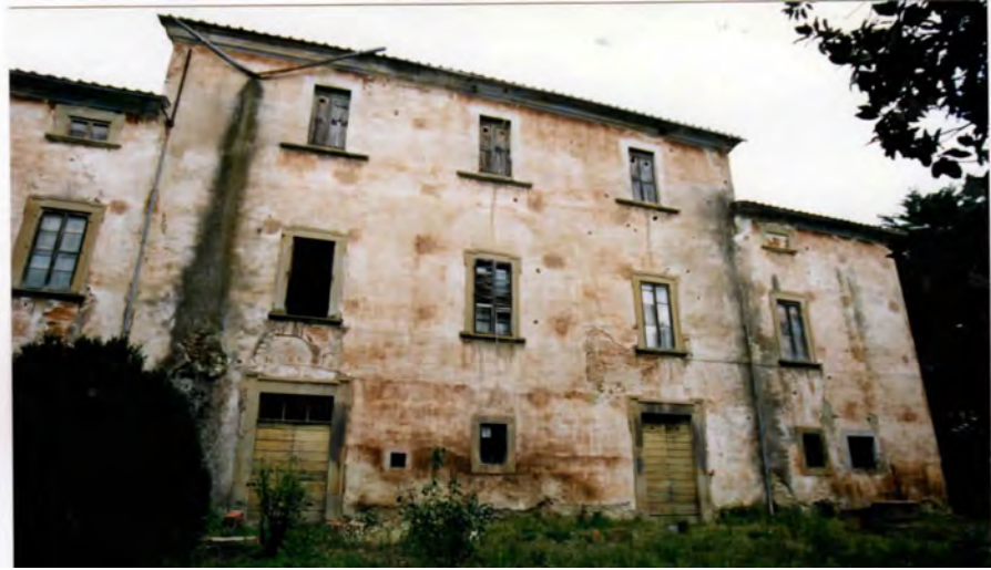
Fig. 114 a. Prospetto sud prima dei lavori (1999): visibile la traccia della pregressa loggia centrale al primo piano (Badia Capolona)
