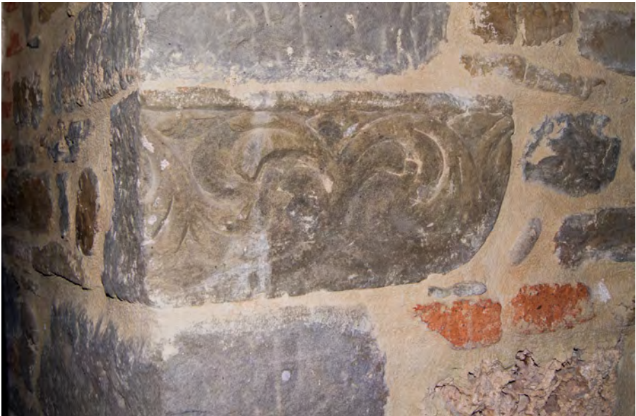
Fig. 14. Frammento di pilastrino in arenaria con motivo a girali (secoli X-XI): elemento di spoglio inserito nella muratura, particolare (Badia Capolona, abside di nord-est, interno)
