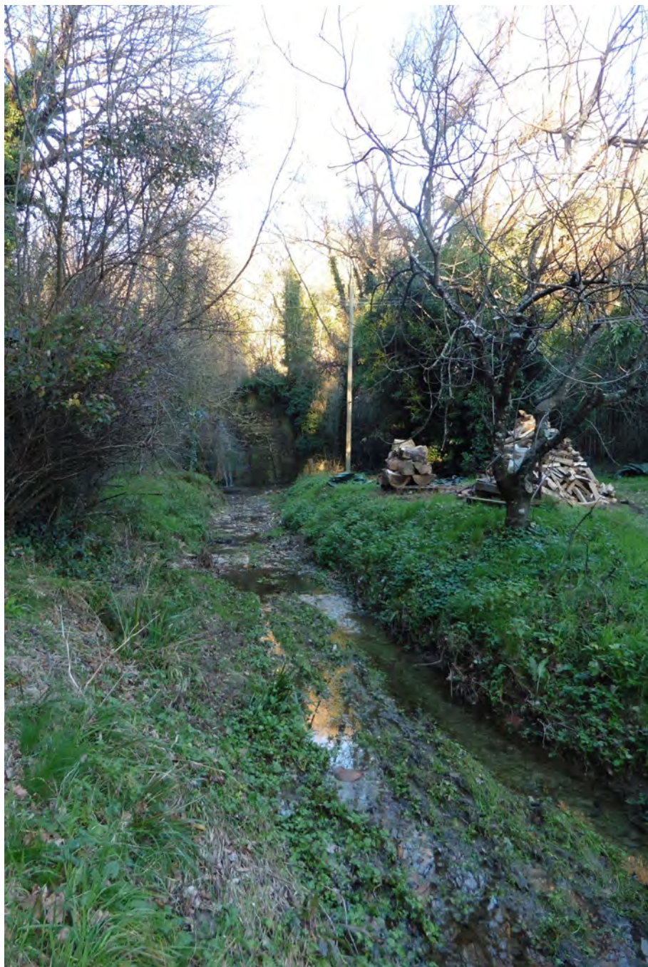
Fig. 134. Opera di sistemazione idraulica sul torrente Fusato, antico fosso della Badia (Castelluccio)
