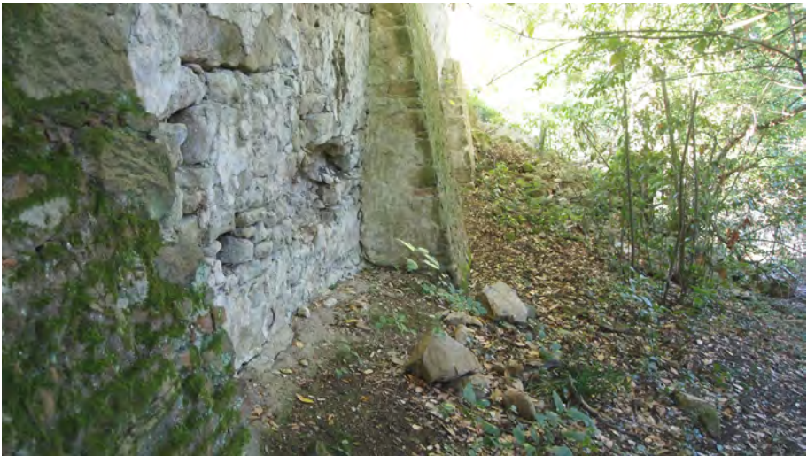
Foto n. 22a e n. 22b – Tratti di muro con problemi di degrado e di stabilità
